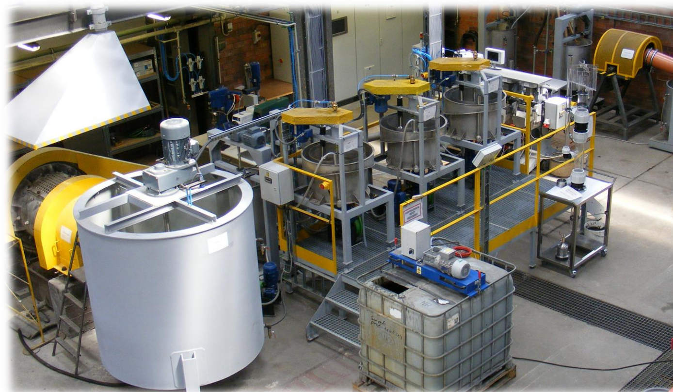
Pilotowa instalacja do flotacji (LPI)
